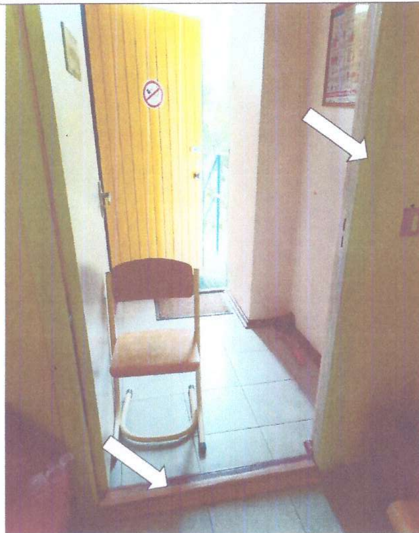
Фото № 6. В тамбуре эвакуационного выхода порог в дверном проеме. Дверной проем контрастно не маркирован
