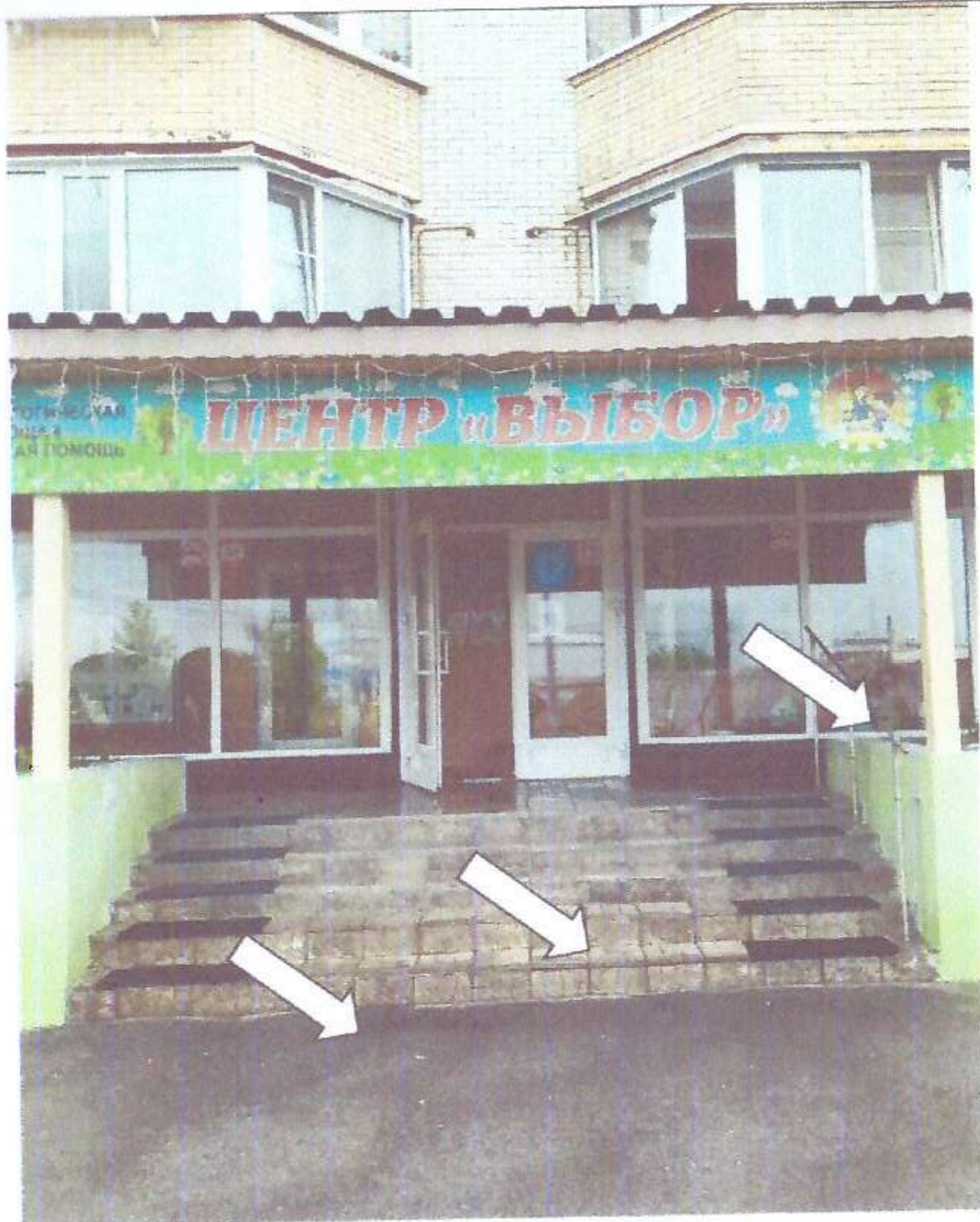
Фото № 1. Поручень с одной стороны лестницы, нет тактильной предупредительной разметки перед лестницей. Ступени контрастно не маркированы
