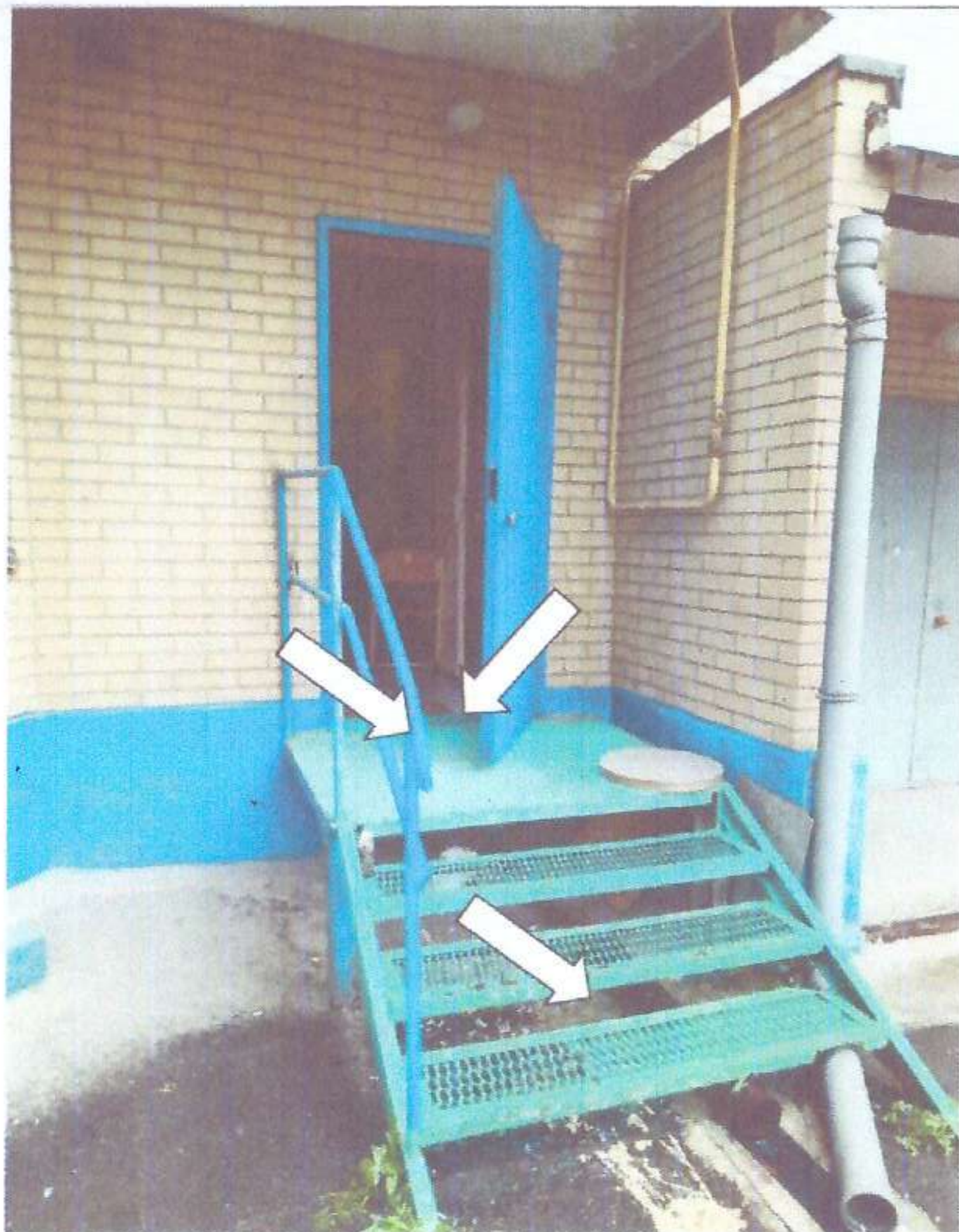
Фото № 7. Эвакуационный выход. Порог в дверном проеме. Ступени без подступенка. Поручень с одной стороны лестницы.
