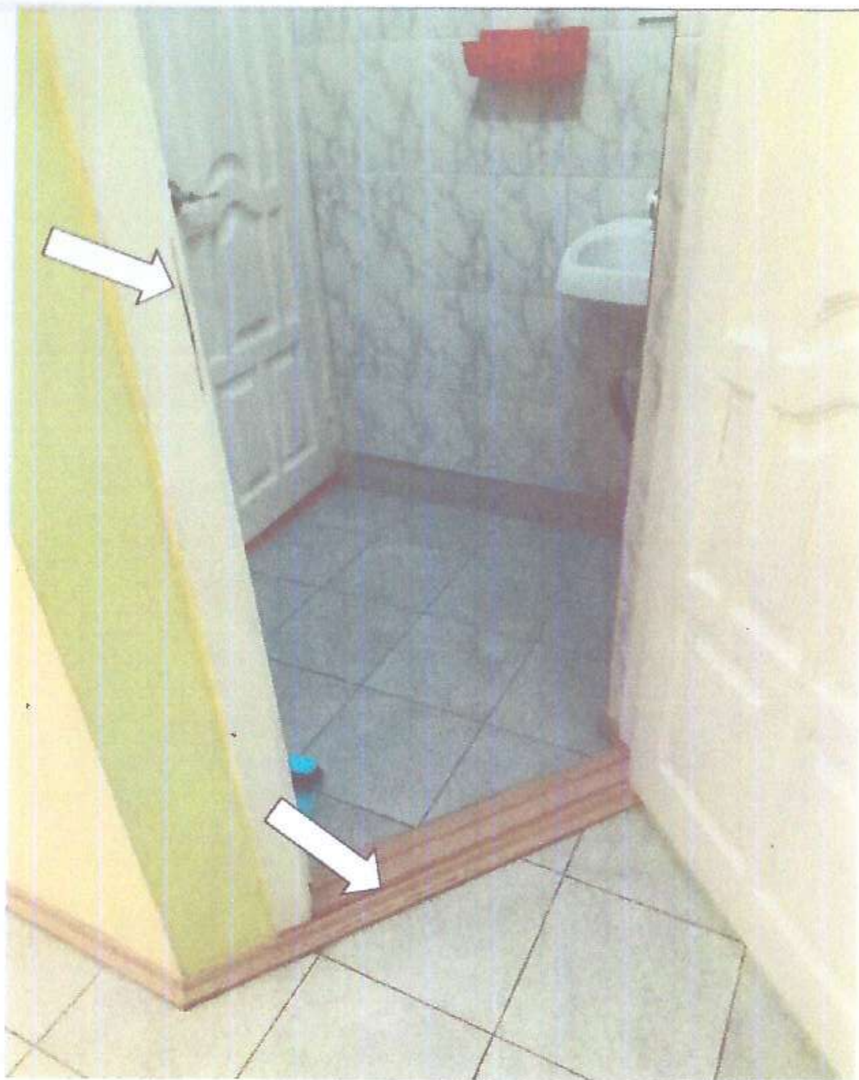
Фото № 9. Дверной проем контрастно не маркирован, порог в дверном проеме
