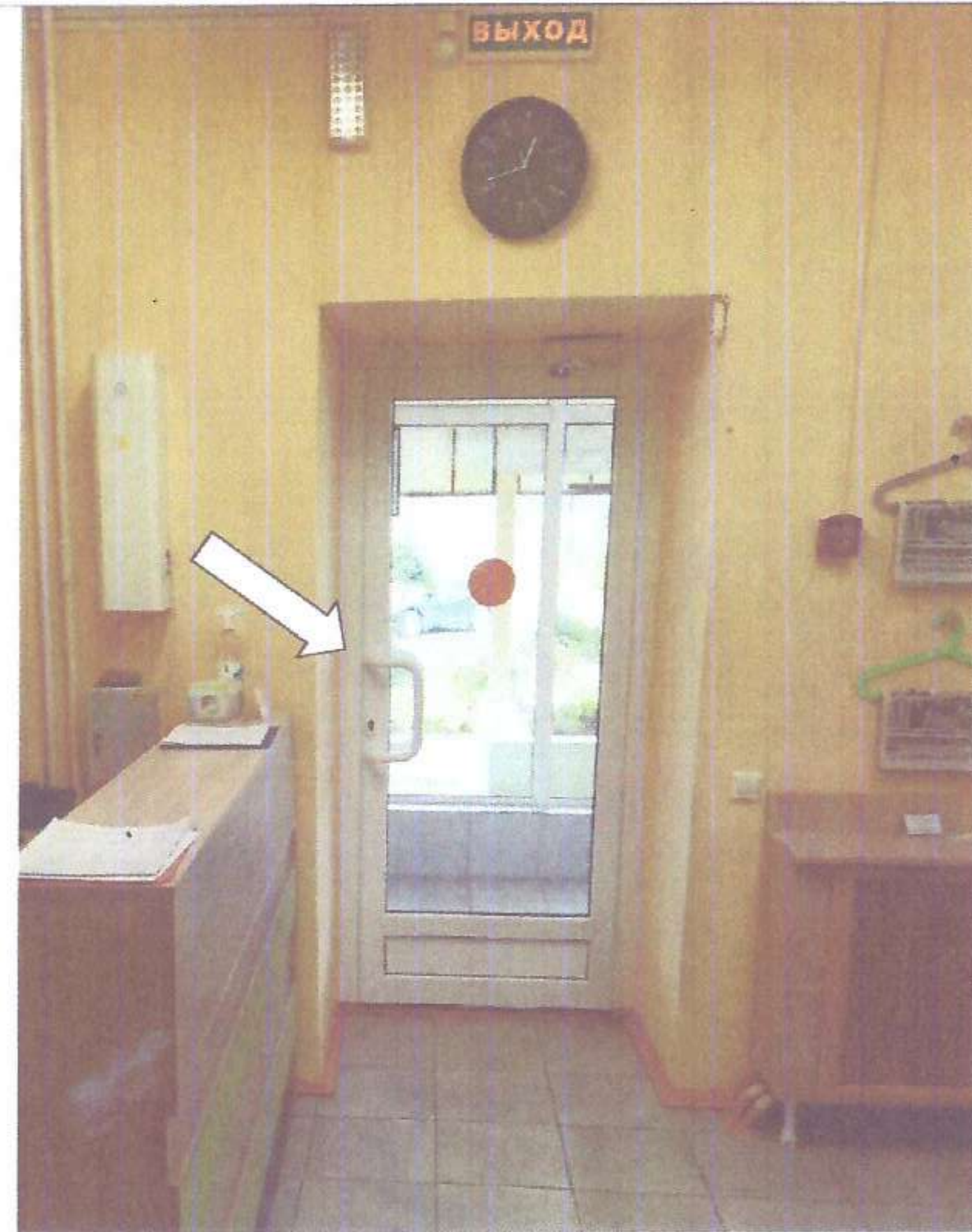
Фото № 4. Дверной проем и дверная ручка контрастно не маркирована.
