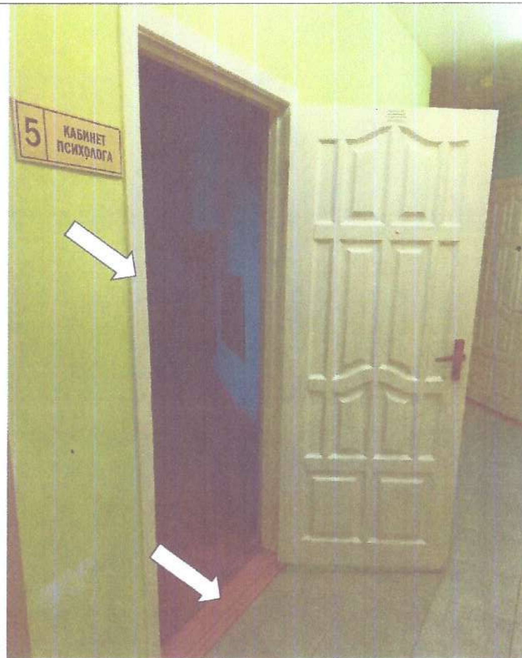
Фото № 8. Дверной проем контрастно не маркирован. Порог в дверном проеме. Табличка нетактильная.
