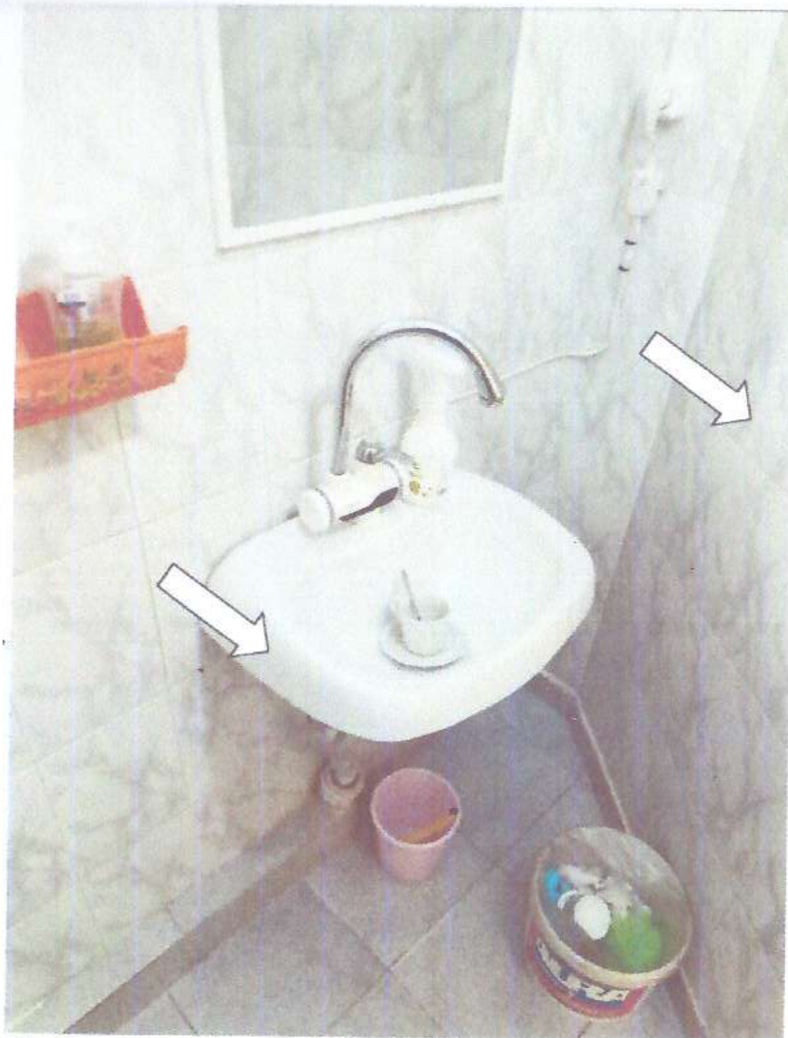
Фото № 11. Нет опорного поручня возле умывальника, крючка для костылей.
